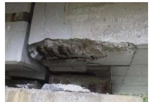
コンクリート桁のひび割れに橋面からの水が廻り桁の一部が大きく欠損
